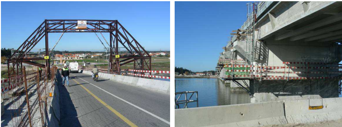
Figura 8 – Plataforma para trabalho na face inferior do tabuleiro e realização dos capiteis de apoio das novas vigas
