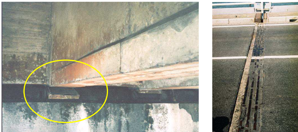
Figura 5 – Deterioração dos aparelhos de apoio do pilar central e abertura da junta de dilatação
