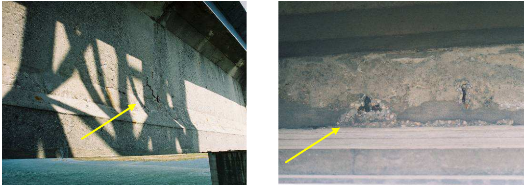
Figura 4 – Delaminação da face lateral de uma viga e corrosão de armaduras
