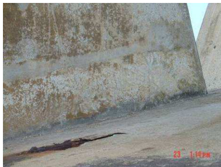
Fig. 18 – Maciço de estacas: corrosão de armadura; delaminação do betão de recobrimento
