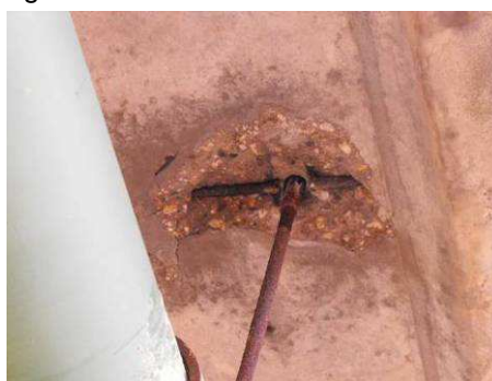
Fig. 16 – Corrosão de armaduras; delaminação do betão de recobrimento
