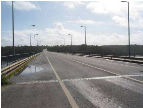
Fig. 21 – Drenagem do tabuleiro: acumulação de água nas bermas
