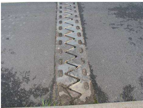
Fig. 19 – Junta de dilatação: acumulação de sedimentos; infestação de vegetação (passeio)
