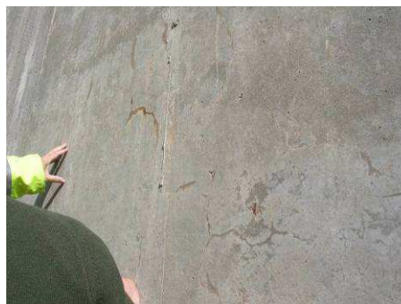
Fig. 12 – Encontro da Margem Direita: manchas de oxidação e fendilhação irregular
