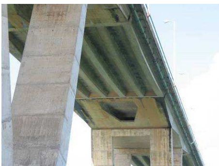
Fig. 13 – Tramo central: manchas de colonização biológica – escorrências
