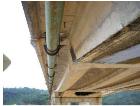
Fig. 22 – Condução de água (lado montante): corrosão dos elementos de fixação de fixação
