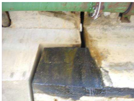
Fig. 14 – Junta de dilatação: escorrência de água
