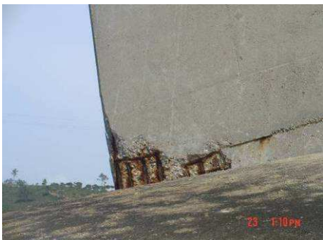
Fig. 17 – Corrosão de armaduras; delaminação do betão de recobrimento
