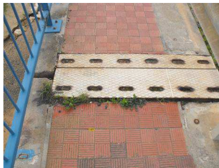
Fig. 20 – Corrosão das chapas de protecção das juntas de dilatação (passeio)
