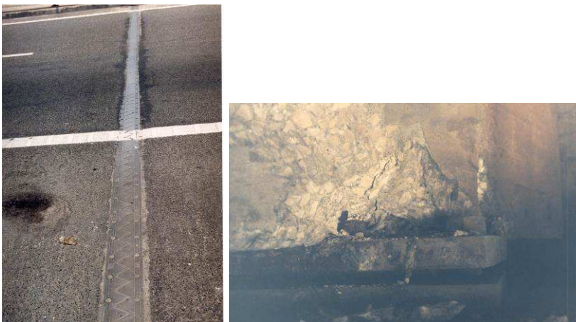
Figura 6 Juntas de dilatação e aparelhos de apoio com danos na zona de fixação
