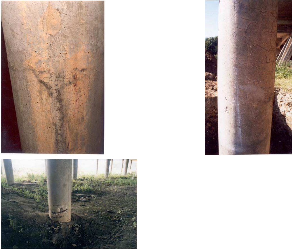
Figura 4 Fendilhação em pilares/estacas e coloração superficial associada aos geles das reacções ASR
