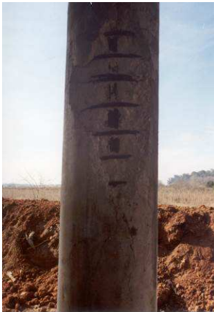
Figura 5 Pilar com significativa corrosão de armaduras e delaminação do betão
