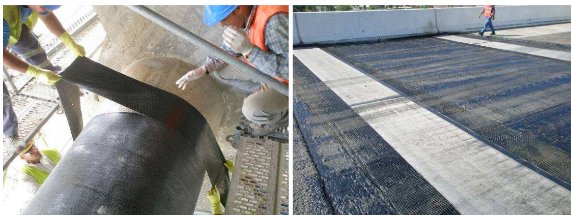
Figura 11 – Reforço das travessas circulares de contraventamento dos arcos com mantas CFRP e impermeabilização do tabuleiro na zona das juntas intermédias.
