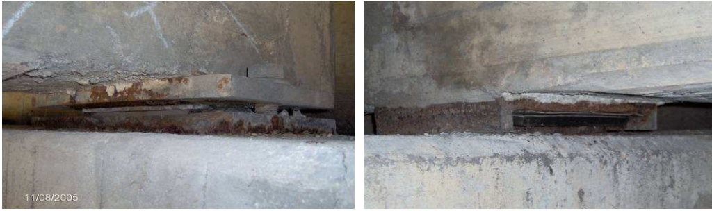
Figuras 6 e 7. - Aparelho de apoio fixo e Apoio móvel com placa de neoprene deslocada.
