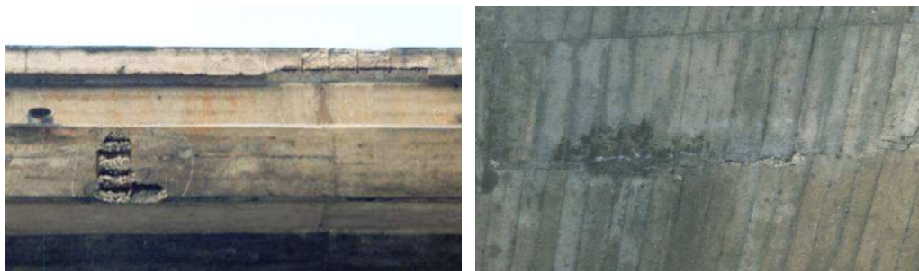
Figuras 4 e 5. - Delaminação do betão por corrosão das armaduras (viga exterior e viga de bordadura) e Junta de betonagem na laje.
