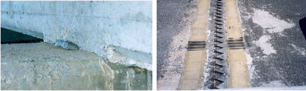
Figuras 8 e 9. - Placa de chumbo deformada e Junta no encontro móvel muito aberta.
