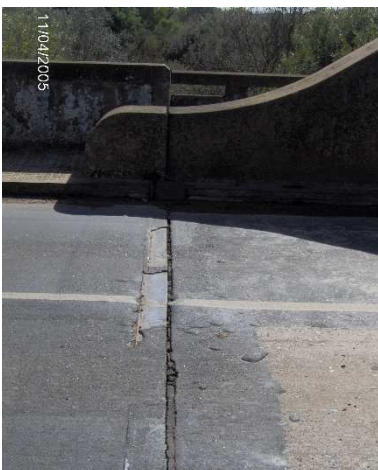
Figura 7 Deterioração das cobrejuntas e do pavimento rodoviário
