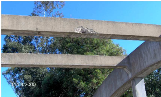
Figura 8 Danos na travessa dos pórticos transversais provocados por embate de veículos
