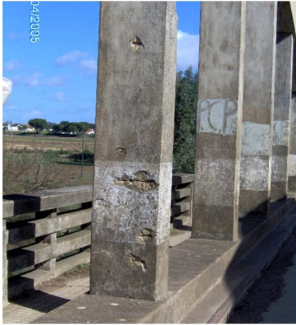
Figura 5 – Corrosão local de armaduras
